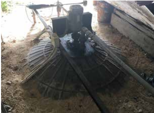
畜産廃棄物からエネルギーを作り出すバイオガスユニット。
